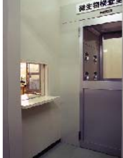
微生物検査室 エアシャワー入口
