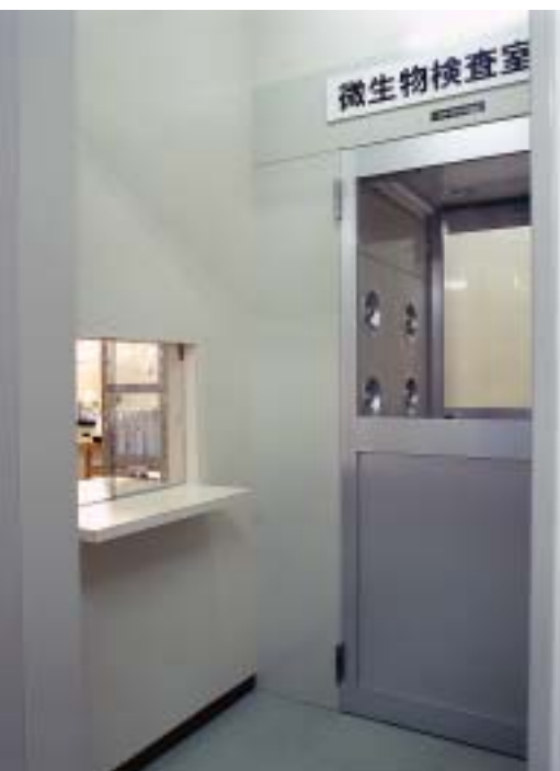
微生物検査室エアシャワー入口
