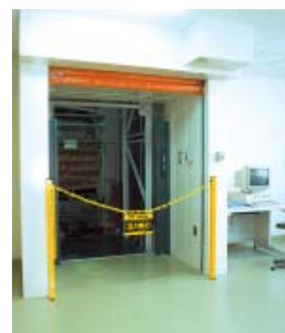
工場内自動倉庫出荷口
