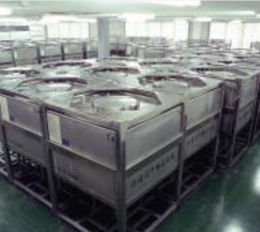
調合液定温保管室
