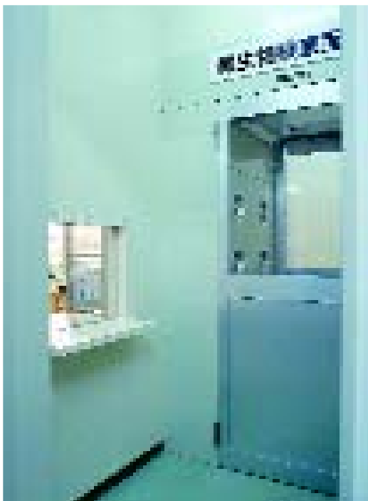
微生物検査室エアシャワー入口
